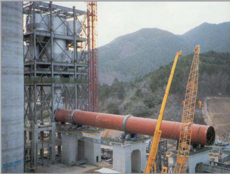
Cement Plant, Kiln 및 부대시설(옥계)
