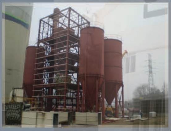
Cement 저장 Silo 설비
